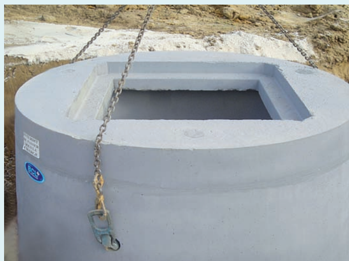
Ouvrage de régulation de l'eau Alkernin, diamètre 1500 cm.
